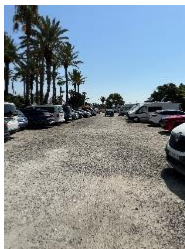
Falta de material - socavones
