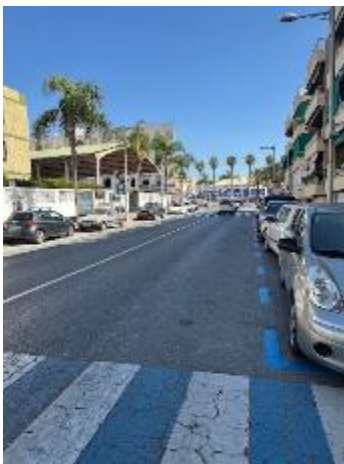
Firme en mal estado
