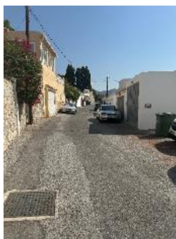
Bacheos del pavimento
