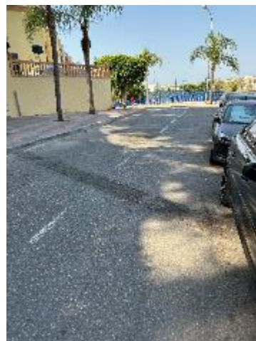
Firme con socavones y disgregado
