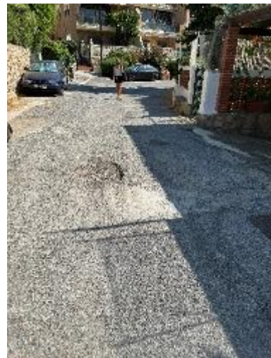
Socavones y firme disgregado
