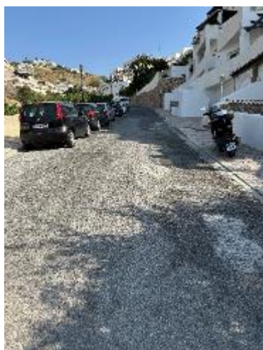
Socavones y disgregación del firme
