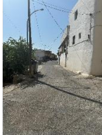
Firme con falta de mástic de adherencia
