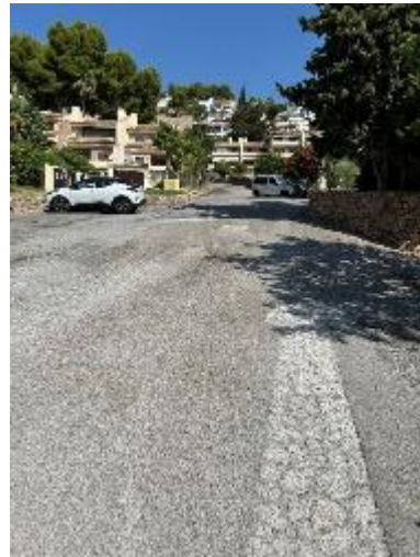
Blandones y falta de adhesión
