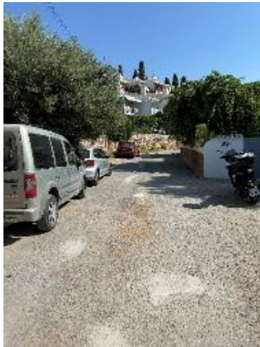
Socavones y falta de mástic
