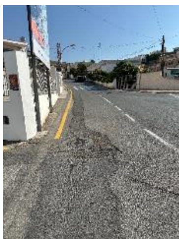
Socavones, hundimiento de tapas de pozos
