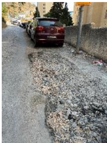
Disgregación de superficie
