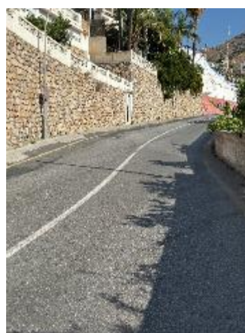
Hundimiento zanja lateral
