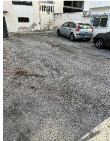
Socavones y firme disgregado
