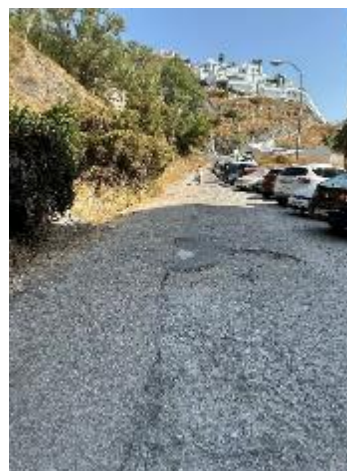
Blandones y disgregación del firme
