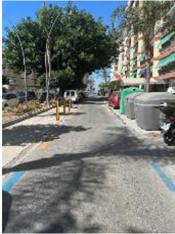
Pavimento disgregado y parchado
