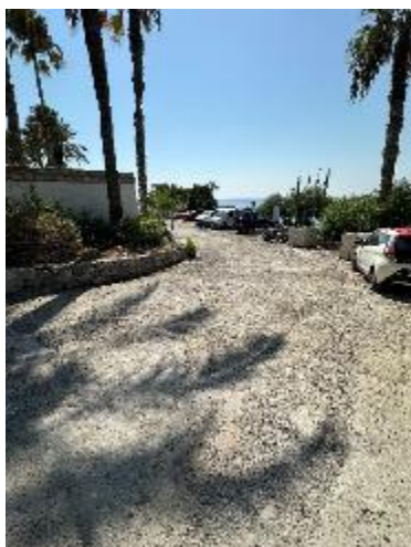
Disgregación completa de la superficie
