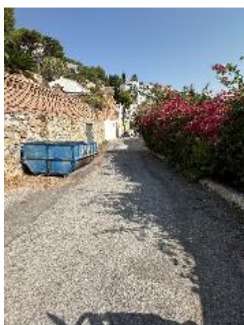
Firme con falta de mástic
