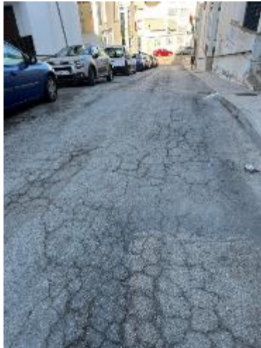
Firme cuarteado por falta de mástic
