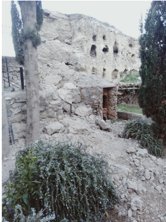
Restos de lienzo de Muralla desprendidos sobre hornos de la Alfarería. Se observan las grandes oquedades en el trasdós de la Muralla.
