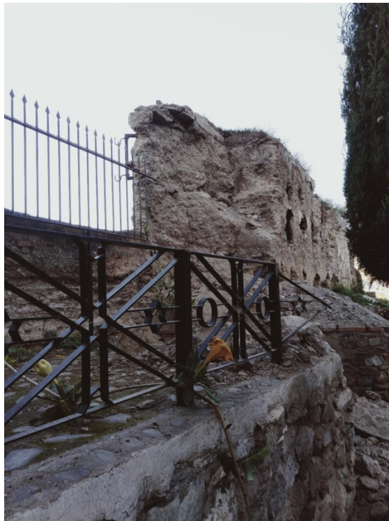
Zona superior del lienzo que ha quedado con escaso espesor en la zona de la Alfarería
