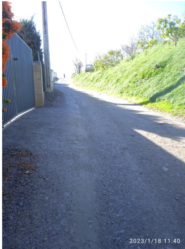
Foto 3. Estado del firme
