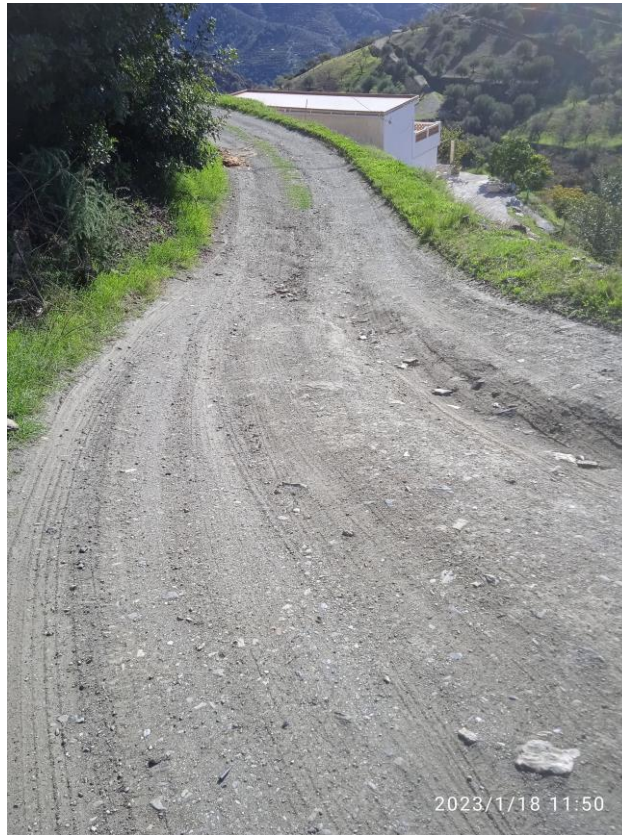
Foto 6. Estado del firme
