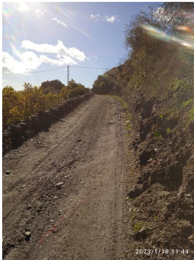
Foto 5. Estado del firme
