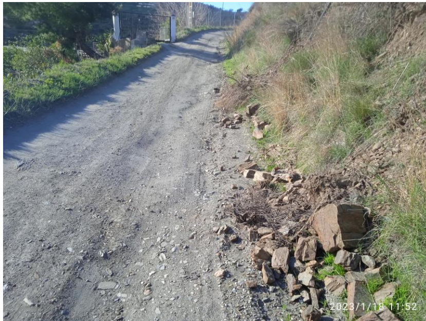
Foto 7. Estado del firme
