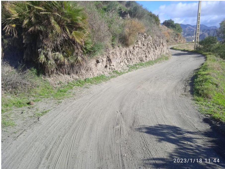
Foto 4. Estado del firme
